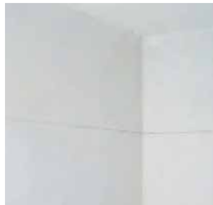
Bild 11 Rissbildung infolge Verkürzung der Decken in Wandlängsrichtung
