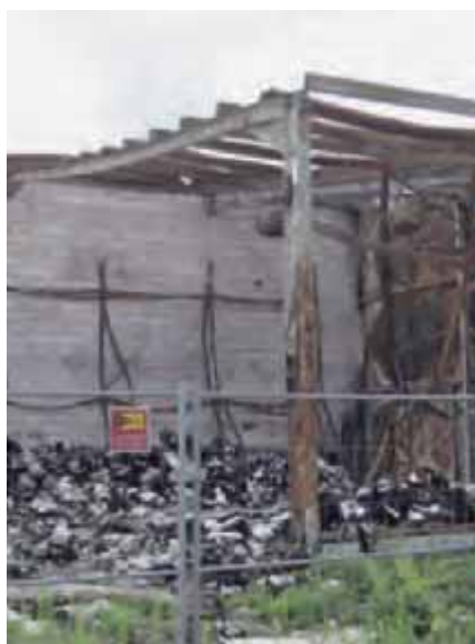
Bild 10 Durch Brand verformte Stahlkonstruktion vor unversehrter Kalksandsteinwand
