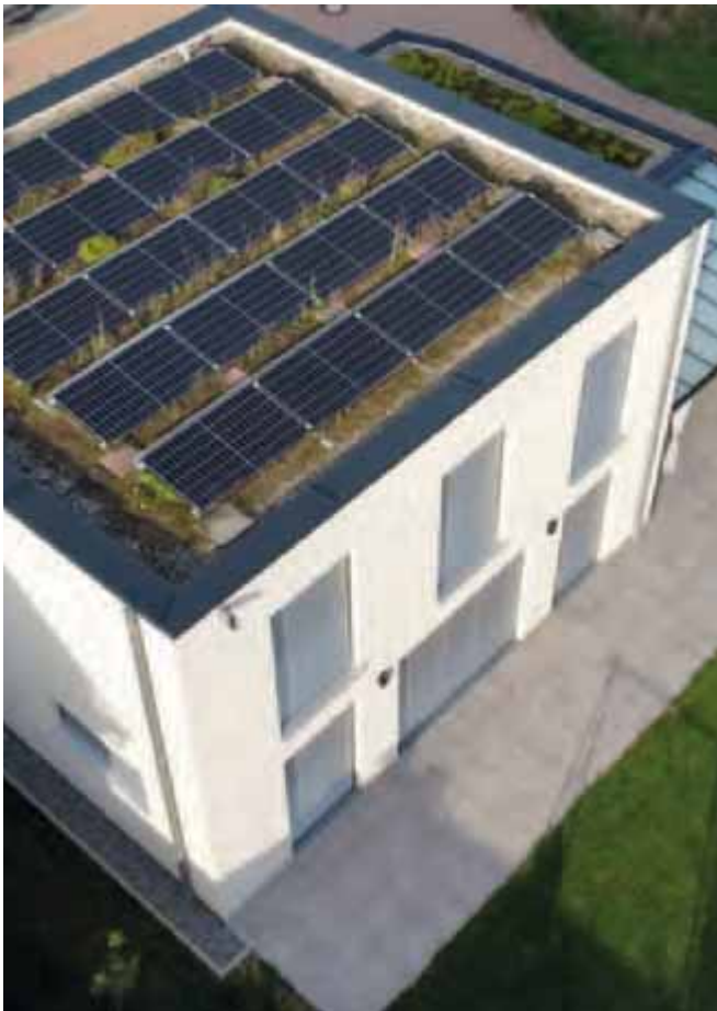
Bild 25 Dach mit Photovoltaikanlage
