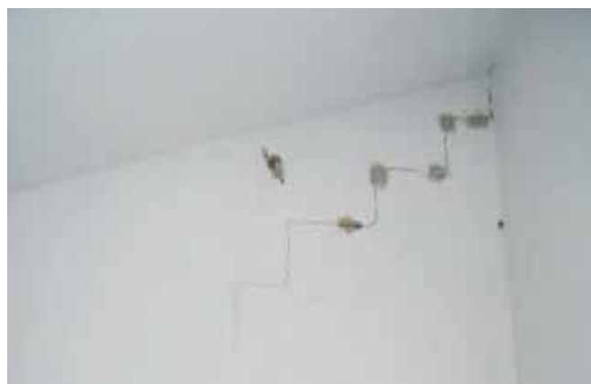
Bild 13 Rissbildung durch Verkürzung eines Stahlbetongurts
